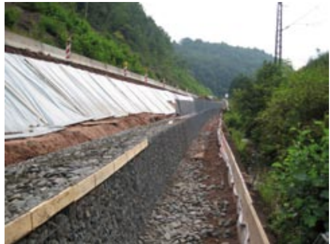
Bild 2: Absturzsicherung an Böschungen
