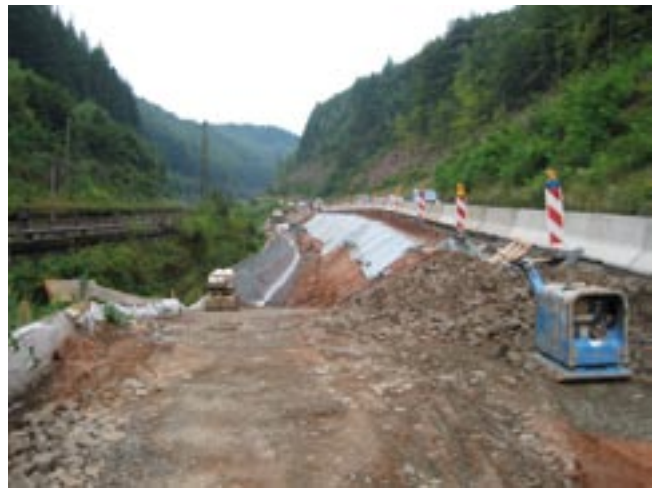
Bild 5: Durch den SiGeKo veranlasste Betonschutzwand zur Verhinderung der Absturzgefahr
