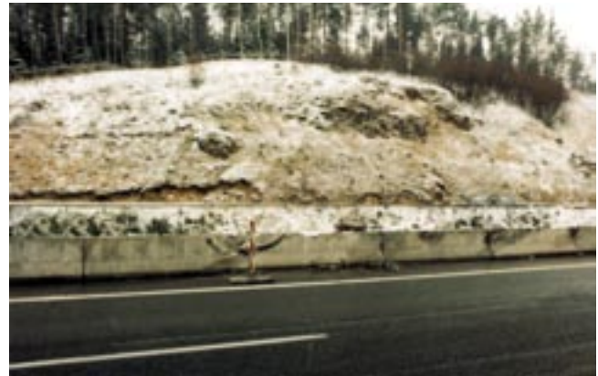
Bild 1: Durch Unfall beschädigte Betonschutzwand im Mittelstreifen
